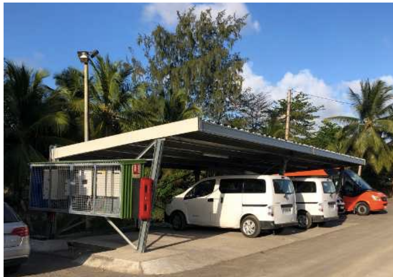
FIGURE 51 : BORNE DE RECHARGE AVEC PANNEAUX SOLAIRES ET BATTERIES DE STOCKAGE A LA STAC SITE DU RAIZET ABYMES
